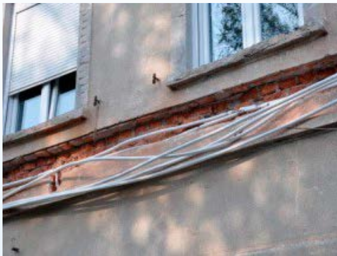
Preglobok utor je oslabil nosilnost zunanjega zidu.
